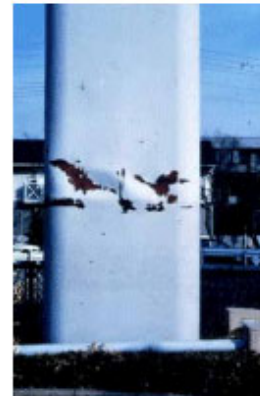
断面変化点付近の局部座屈(2)
