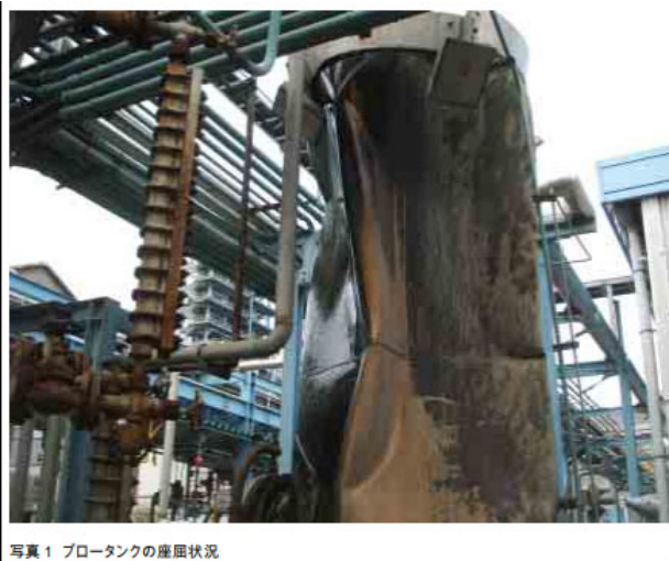
写真1 ブロータンクの座屈状況
