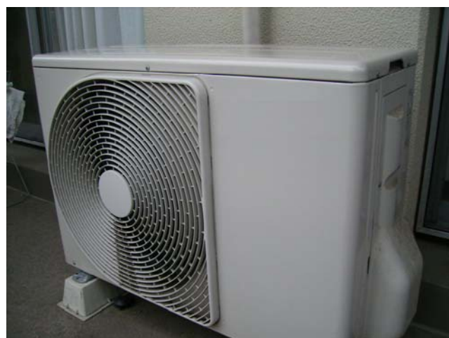
図 4 室外器（凝縮器）
